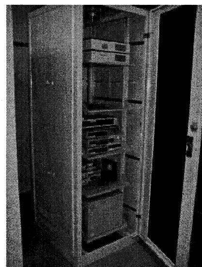
加入機関用のラックの 内部
