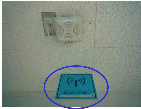
図3: 無線 LAN アクセスポイント設置サイン
