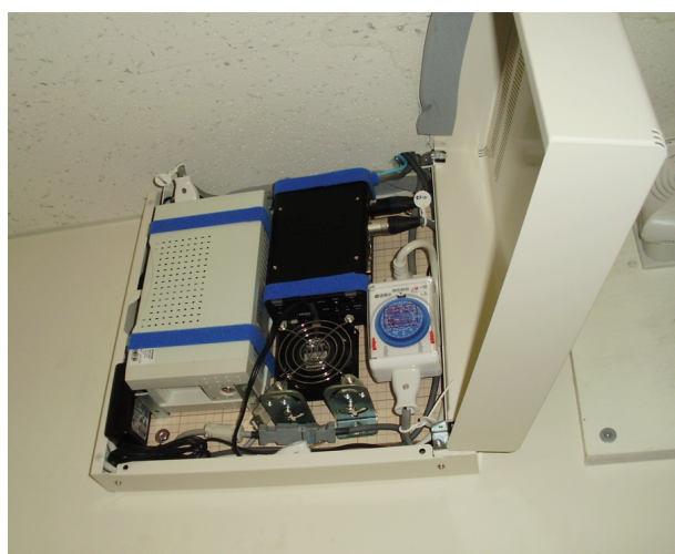
図 4: 教室に設置した小型ラック
