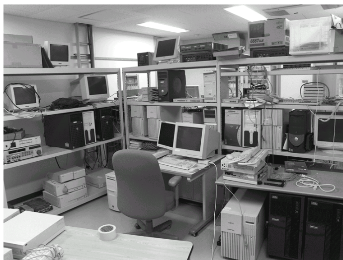
図 3: 情報工学部サーバ室
